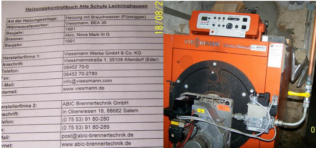
Abbildung 3 Heizerzeuger Alter Kessel aus 1991 Viessmann Vitola ohne WW-Bereitung, Leitungen im unbeheizten Bereich gedämmt, kein WW-Verteilungssystem im Haus, WW-Zubereitung im EG und OG per Durchlauferhitzer
