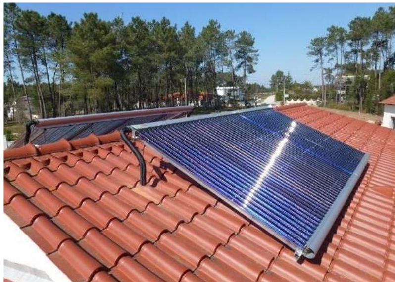
Abbildung 4: Thermische Solaranlage Weiser Protect
